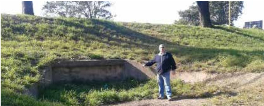
Avda. Costanera, un paso construido por debajo de ella, para que las aguas de lluvia pasen hacia el río; está actualmente tapado. Está a la altura de la cancha de hockey femenino y rugby, y la subida de la Avda. Alsina.
